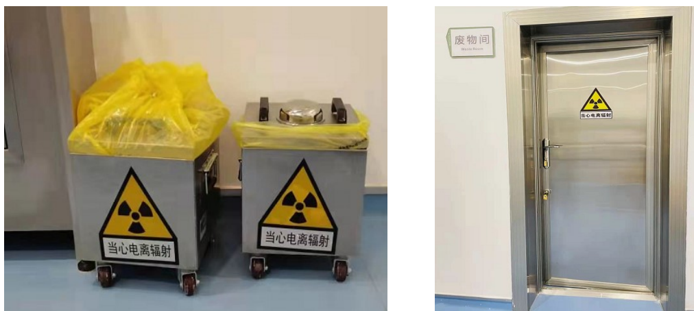
图 4-16 本项目放射性废物铅桶及放射性废物暂存间
