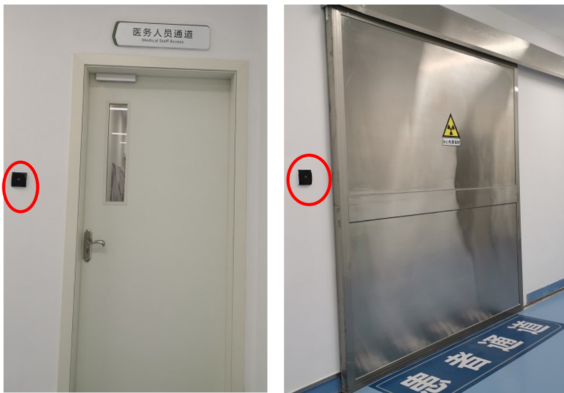
图 4-11 本项目医院核素诊断与治疗工作场所（东区）医务人员及患者通道门禁系统
