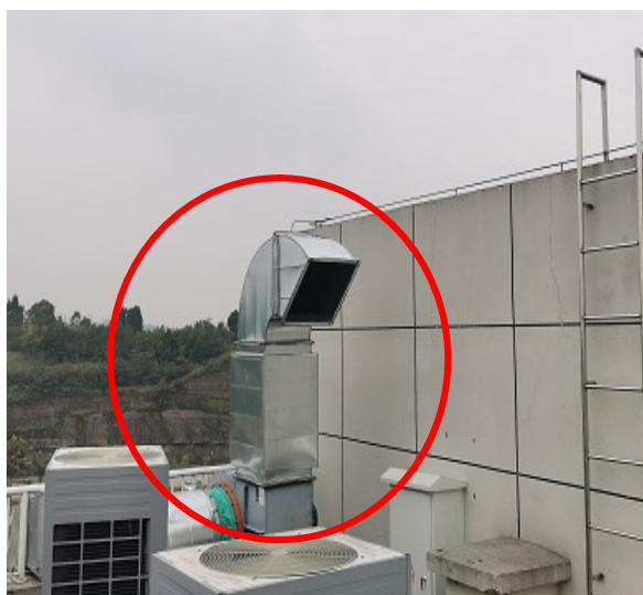
图 4-17 本项目通排风系统屋顶排风口
