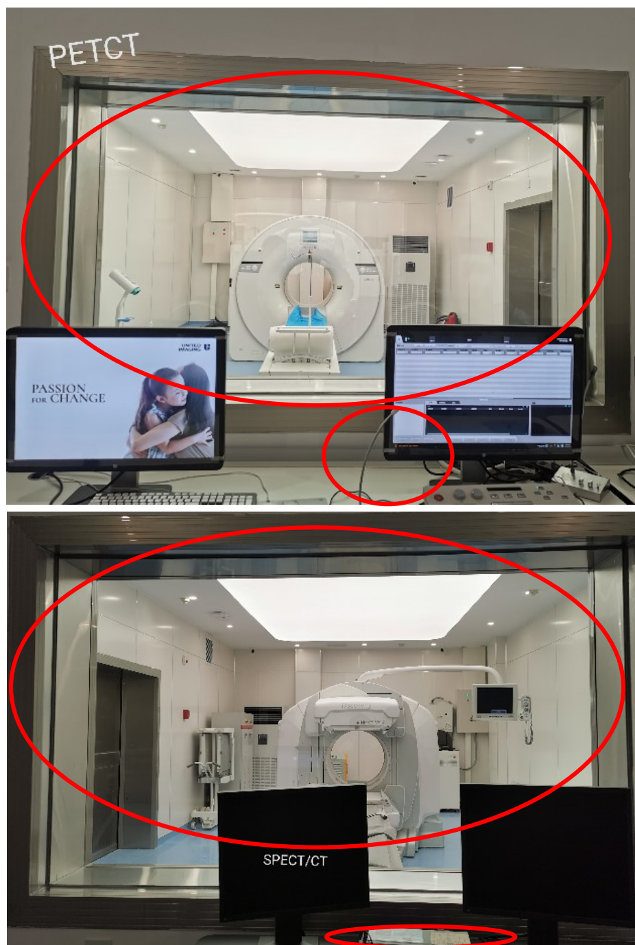
图 4-8 SPECT/CT 机房及 PET/CT 机房观察窗及对讲装置
