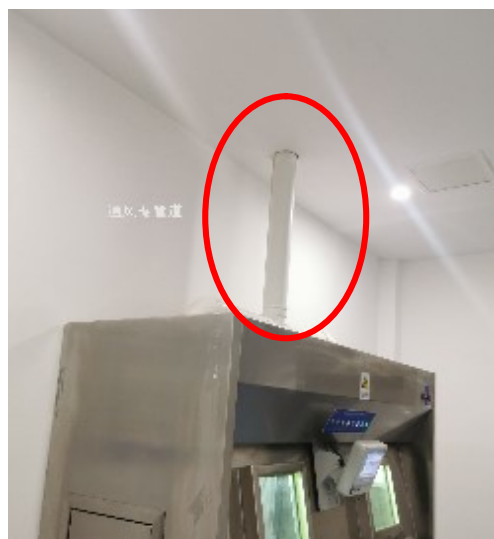
图 4-18 本项目通风橱通风管道
